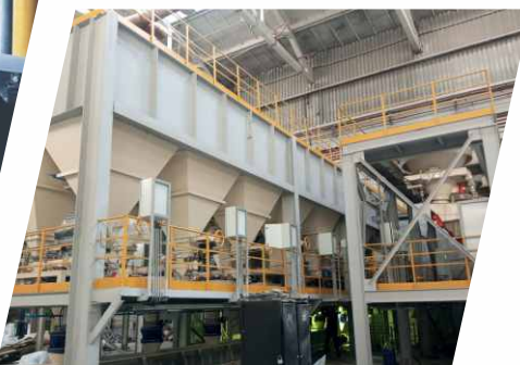
Дозировочно-смесительная линия, ТОО «Казогнеупор», Казахстан, Рудный
